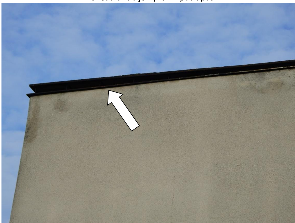
Fot. 13. Szczelina na styku stropodach - ściana (możliwe miejsce lęgowe jerzyków Apus apus )
