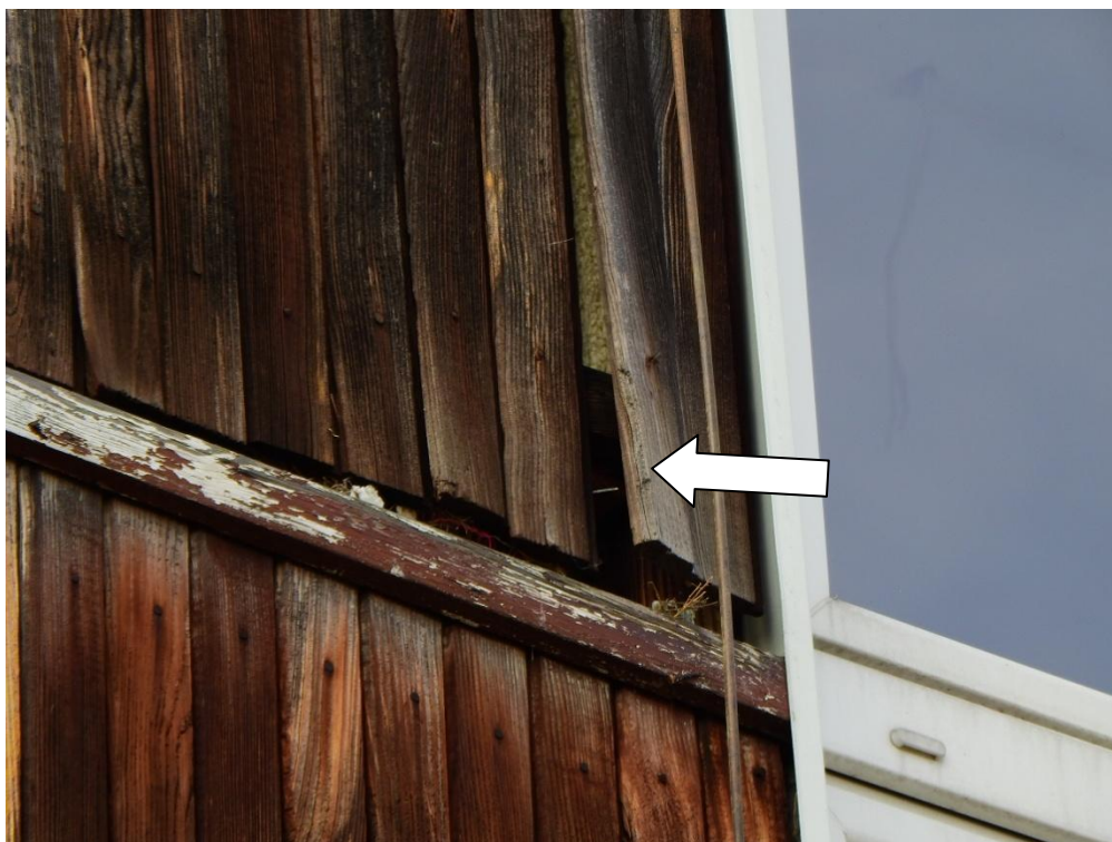
Fot. 14. Miejsce za odstającą deską w elewacji - wykorzystywane przez wróble, mazurki lub kopciuszki Phoenicurus ochruros (widoczne pozostałości materiału gniazdowego)
