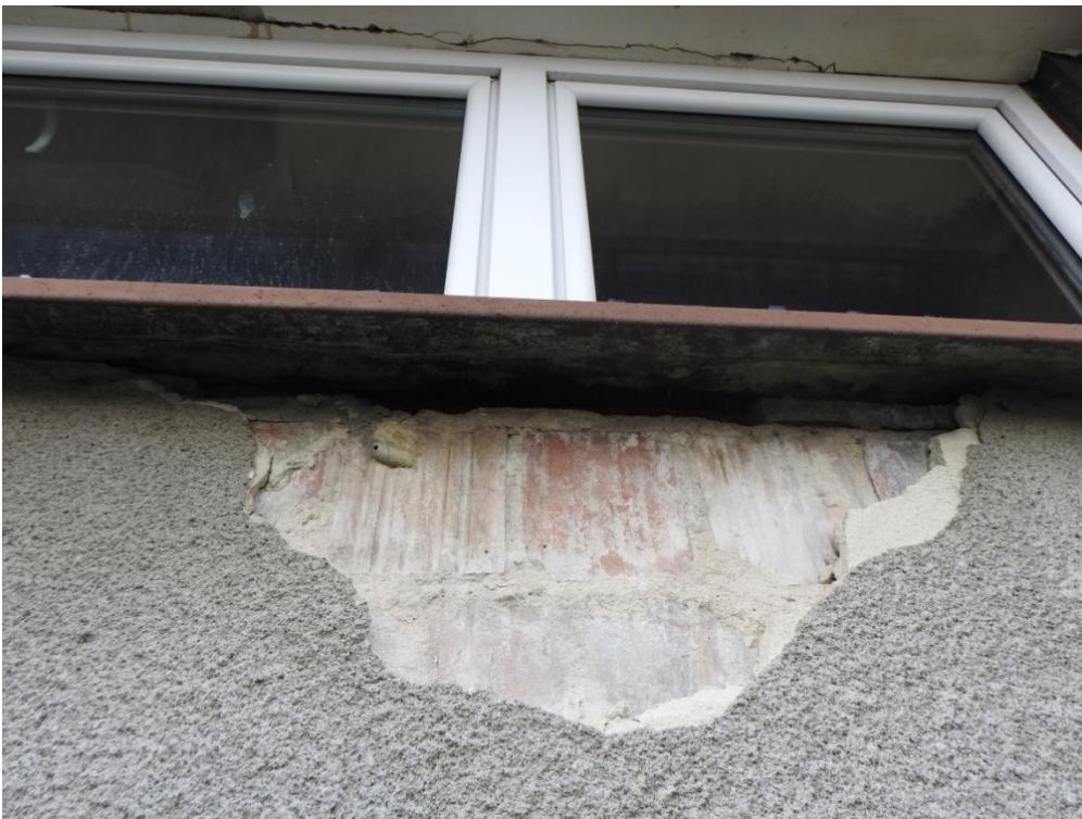
Fot. 17. Szczelina pod parapetem jednego z okien budynku A - potencjalne siedlisko dla jerzyków, wróbli, a także nietoperzy
